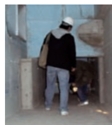
クールヒートトレンチ。学部棟の長さだけ続いている
